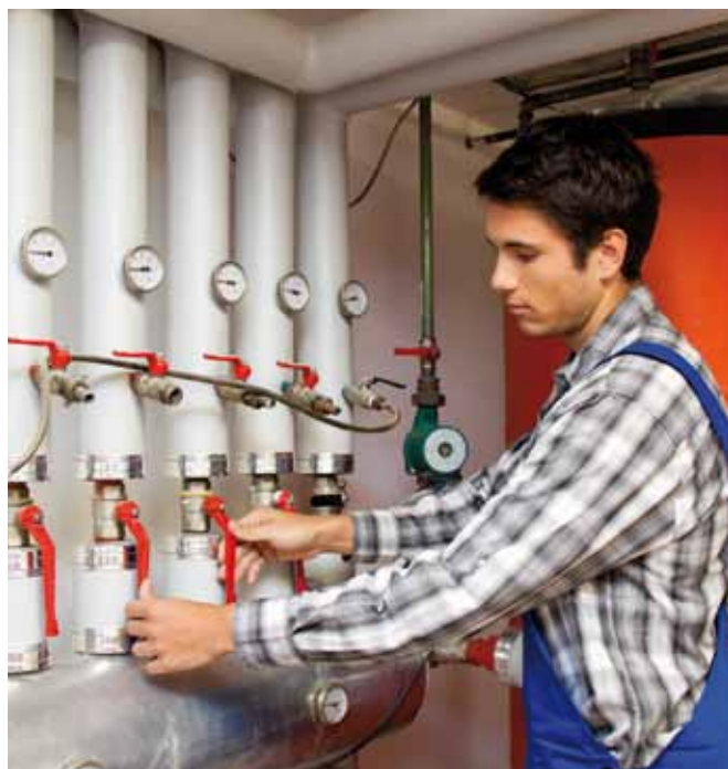
Ein Heizungspumpentausch lohnt sich: Moderne, energiesparende Pumpen passen die Leistung automatisch an!
